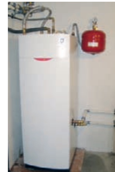
Nur ein Vorteil von vielen: die platzsparende Aufstellung der Wärmepumpe (Foto: Wärme-tec)
